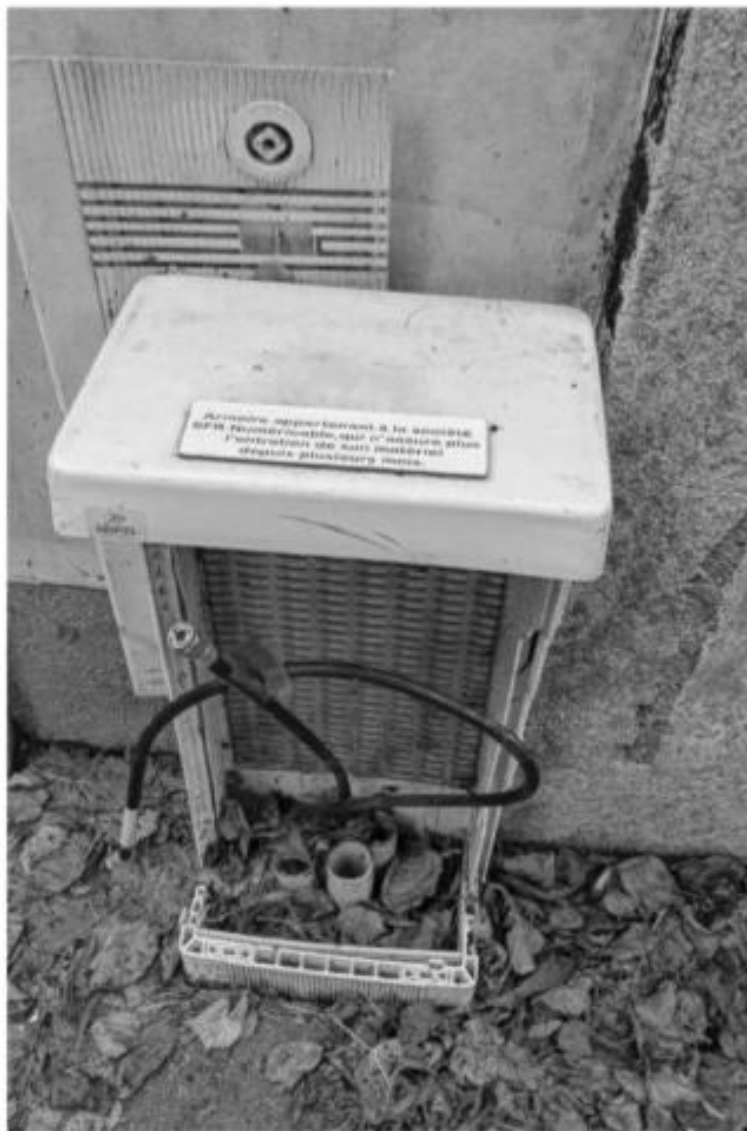
Des armoires béantes restent encore présentes sur les trottoirs de Versailles.
