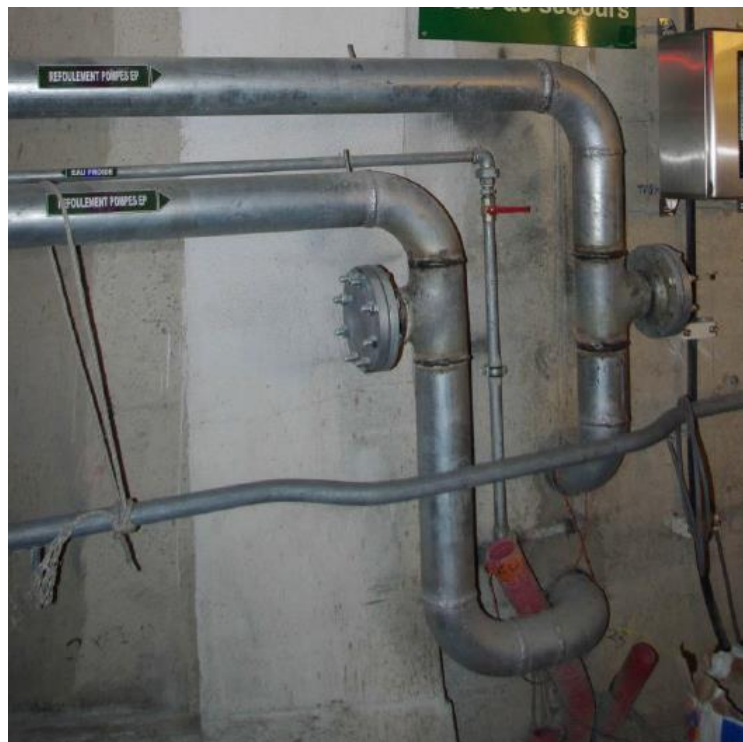
Vue d'une partie du système d'évacuation de l'eau
