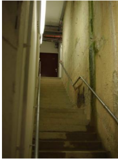
Accès vers local technique de ventilation
